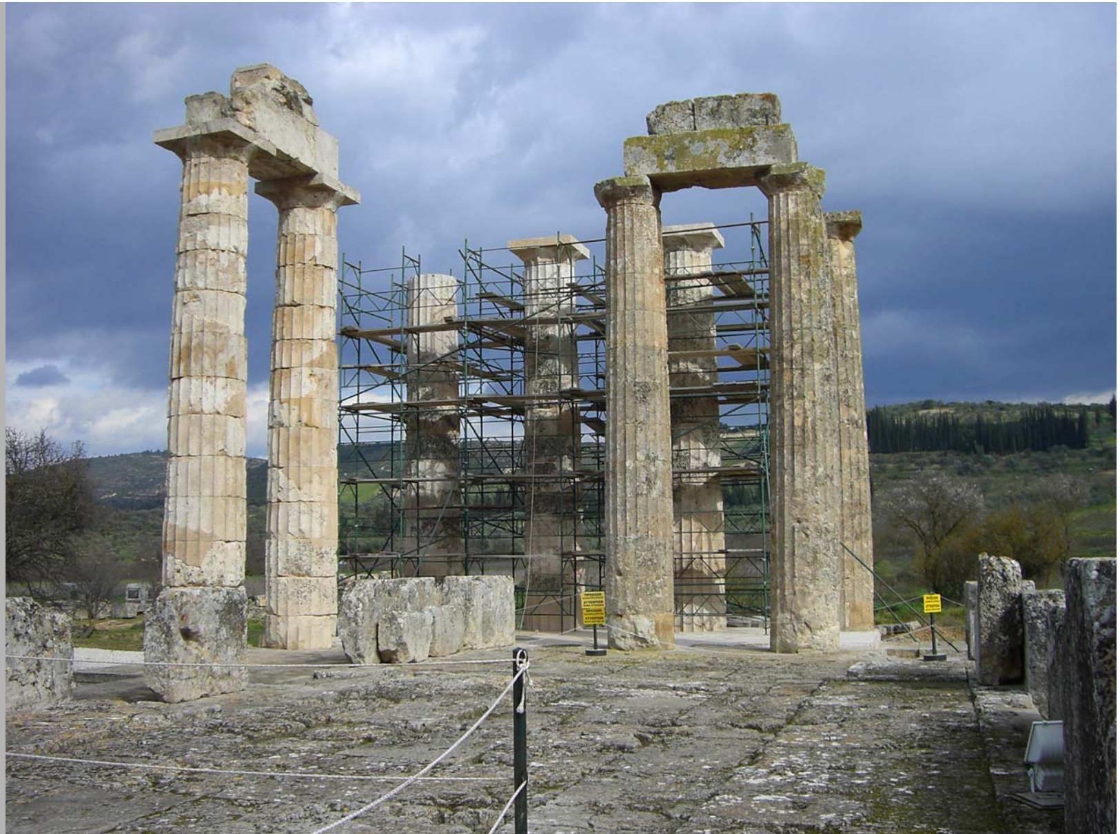
Estado actual (2008) de los trabajos de reposición de columnas, previa limpieza de los bloques. De ahí la diferencia de color con las tres de la izquierda, que son las que vio Miranda
